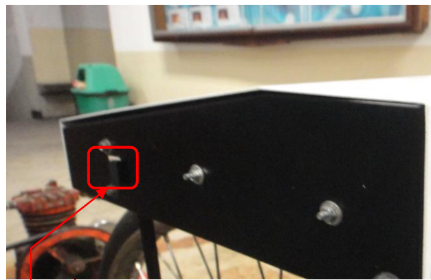
สวิทช์เซอร์กิตเบรกเกอร์ เปิด-ปิด ชุดวงจรกำลัง
